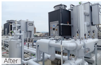
新しくなった屋上の空調機器
